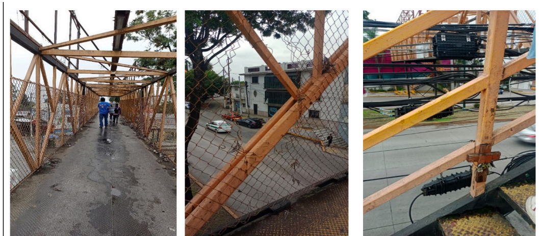
Figura 3. Estado actual de los puentes peatonales de la avenida Lázaro Cárdenas
